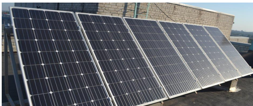
Рис. 4. Загальний вигляд секції фотоелектричних модулів, встановлених на даху тягової підстанції
